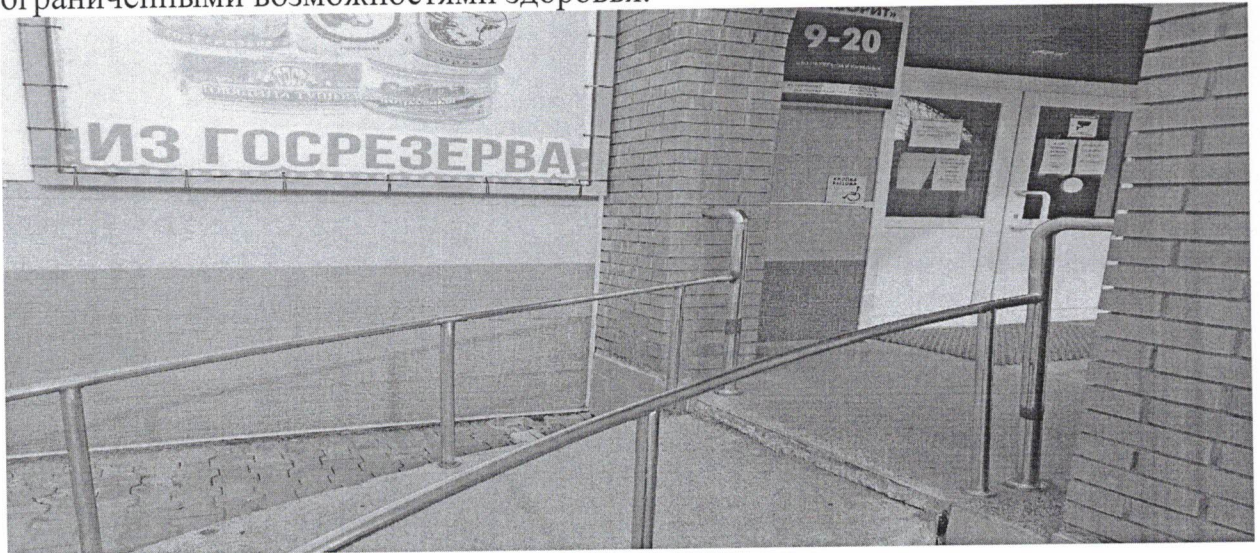
Фото № 1: выявлены нарушения
